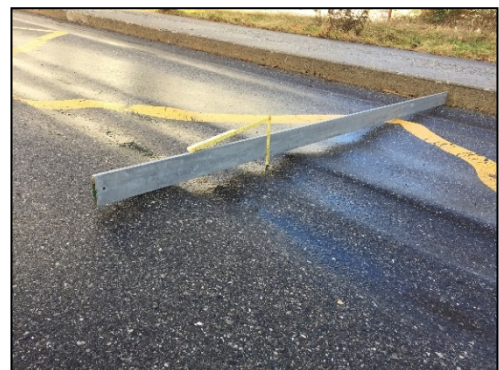
Déformations arrêts de bus Les Chênes
