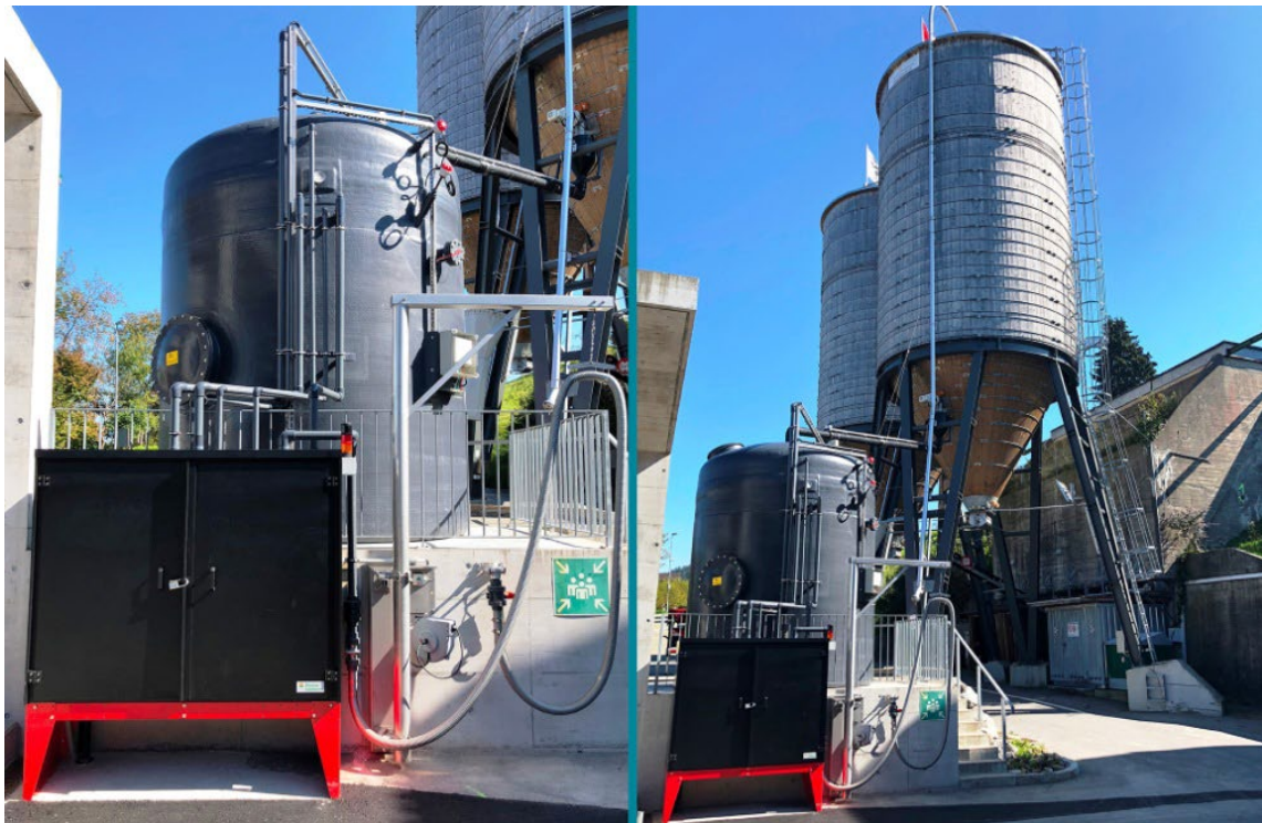
Exemple de cuve de mixage de saumure
