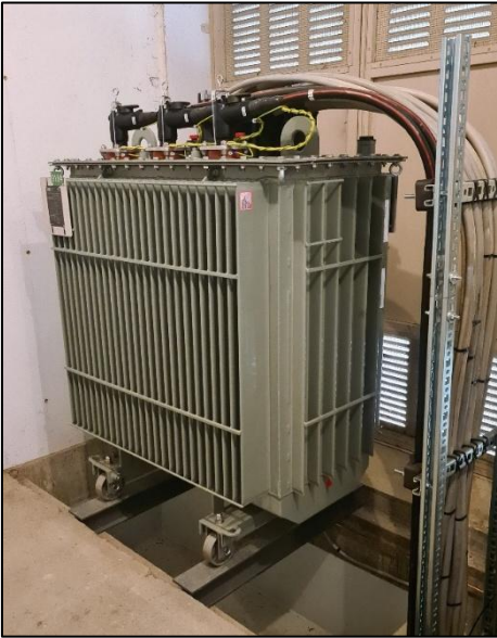
Nouveau transformateur (MT)
